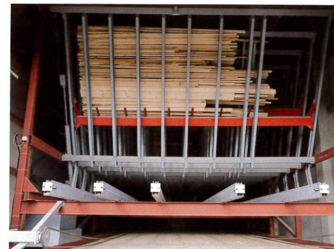
Am hinteren Ende der Linie befindet sich noch eine zusätzliche Aufgabemöglichkeit für Schnittholzgebünde. Durch den automatisierten Reinigungsförderer bleibt zudem das Areal unterhalb der Sortierboxen stets sauber
